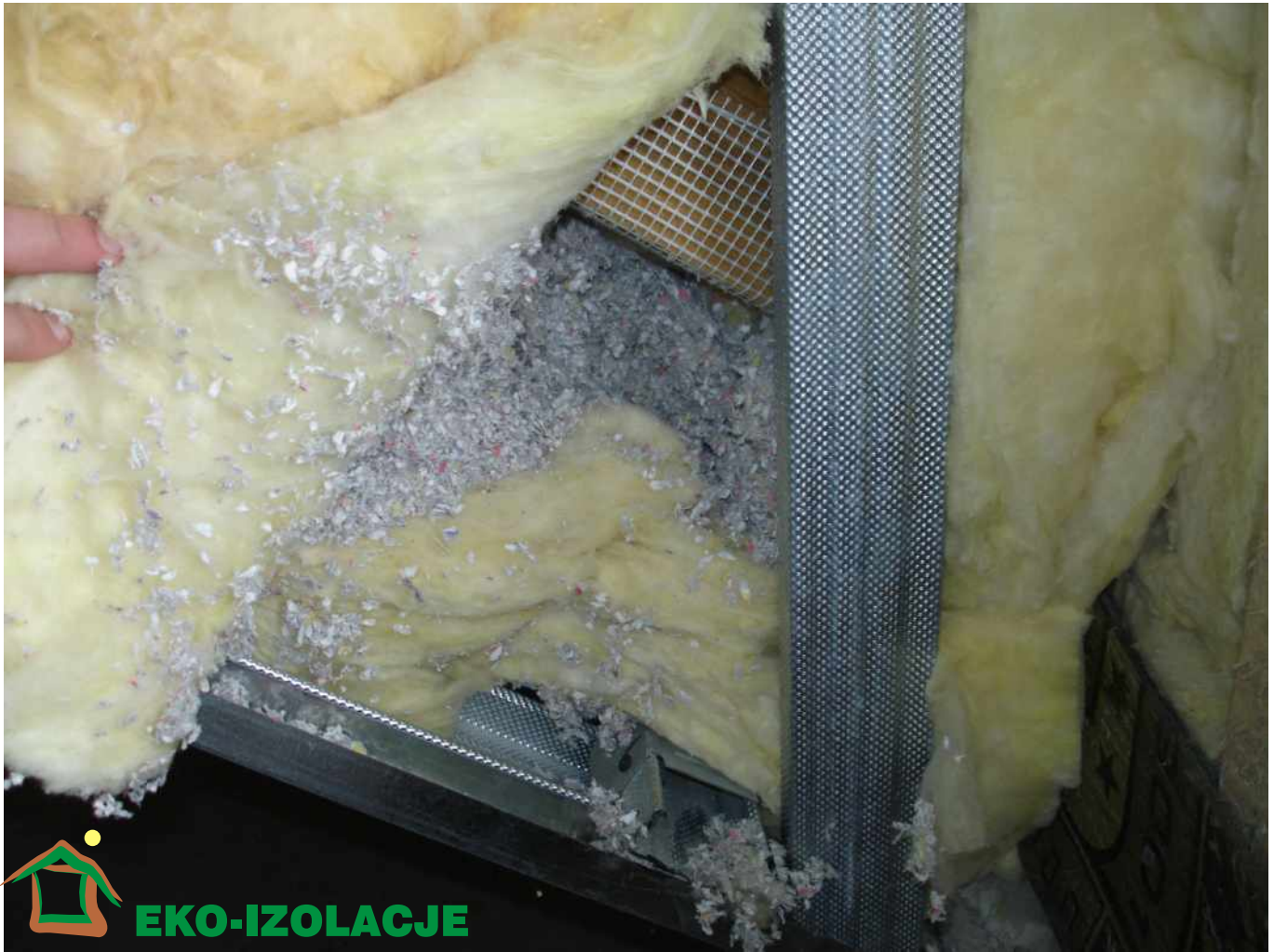
Uzupełnienie docieplenia celulozą Ekofiber między warstwami z wełny mineralnej w połaci dachowej w ilości w/g normy
